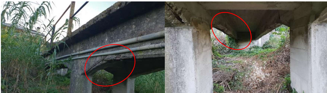
Figura 1.5 – Individuazione di alcune parti degradate che interessano sostanzialmente le travi.
