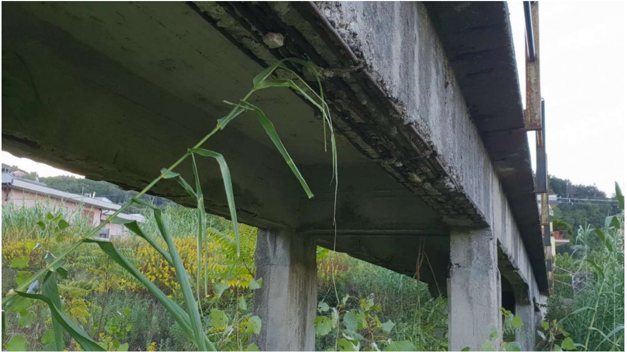
Figura 2.13 – Vista dall'intradosso della struttura della terza campata in sponda sinistra. La trave di valle evidenzia zone con espulsione del copriferro e armature esposte alla corrosione
